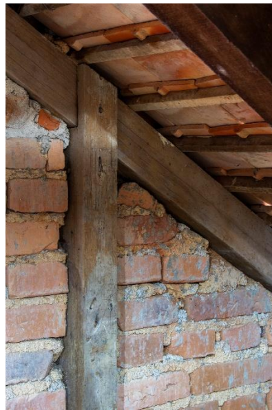
Fig. 11: Sótão com vigas em madeira, chão de tábuas e parede de tijolos aparentes. Casa de Campo do Governador Hercílio Luz, Taquaras. (Foto de novembro de 2012).
