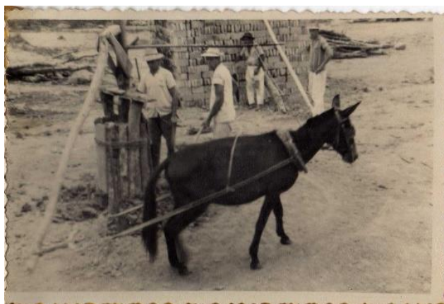
Fig. 10: Registro da fabricação de tijolos. Fotografia de Frei Raul Bunn, entre os anos de 1969-1971, durante a construção da quinta e atual Igreja de Loeffelscheidt (acervo da Igreja Nossa Senhora da Glória).
